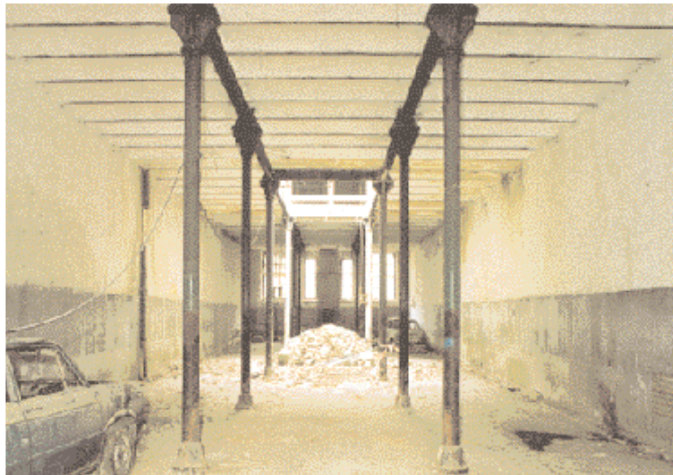
FOTO 2. Estado inicial de la estructura.
