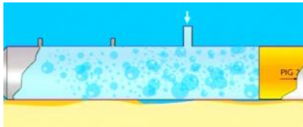
Introducción de agua clorada
