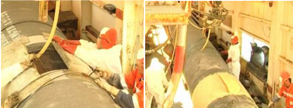
Colocación del molde metálico y protección exterior de la junta con grava y poliuretano
