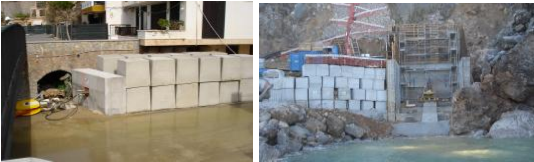
Arquetas de tiro en Sóller y Sa costera
